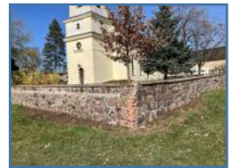
Die defekte Mauer muss instand gesetzt werden.
